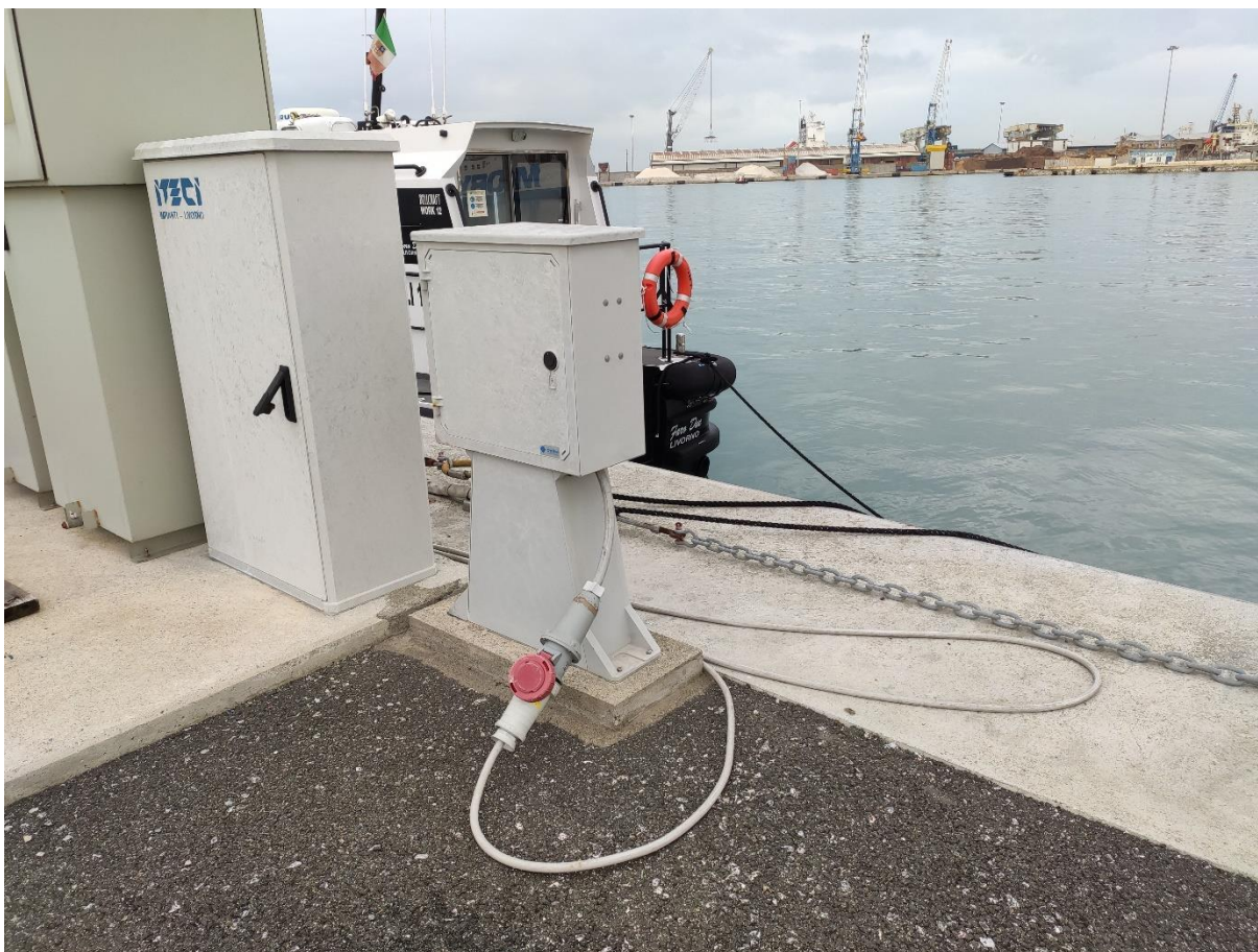
Immagine 5: collegamento elettrico attuale
